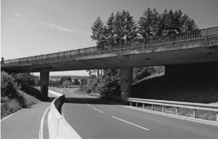
Brücke über die Rengoldshausenstraße Anmerkung: Die unterführte Straße wird genau in diesem Bereich gesperrt. Quelle: Regierungspräsidium Tübingen, Roland Aspiron
